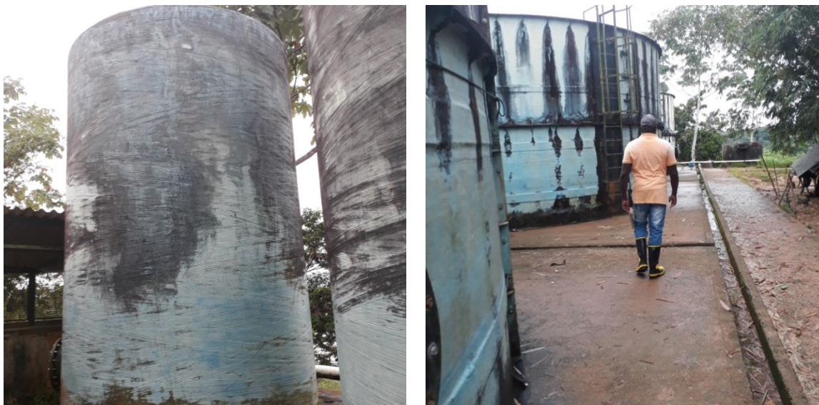
Sedimentadores y filtros descendentes de la planta de tratamiento de agua potable (Sin cumplimiento de funciones no potabiliza el agua que viene de la quebrada Agua Fría)
