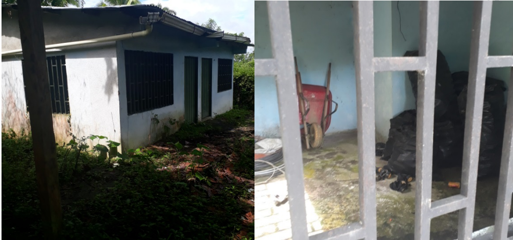
Caseta relleno sanitario en abandono
